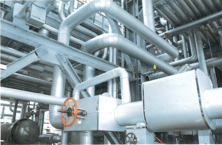
Vor Revisionen wird die Isolierung meist vollständig entfernt, um darunterliegende Anlagenteile zu prüfen.
