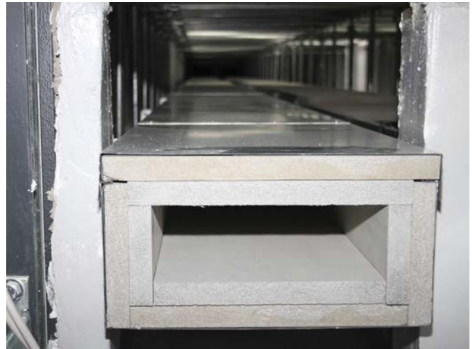
Bild 2 Den Monteuren stand eine Arbeitshöhe von nur 90 Zentimetern zur Verfügung. Die einfache Handhabung des E-Kanals erleichterte den Einbau erheblich.
