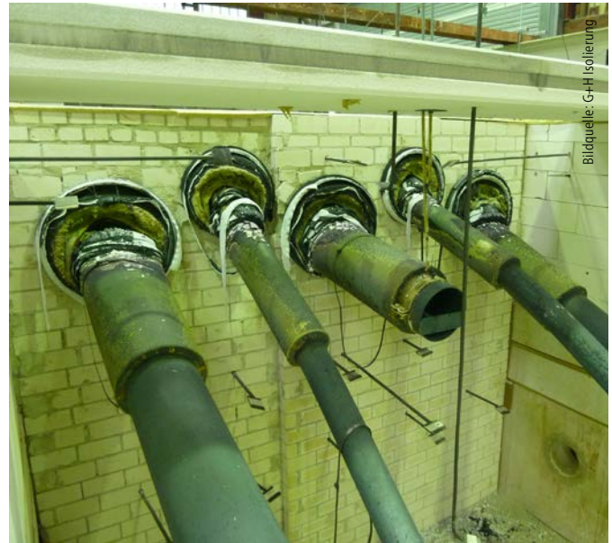
Abb. 2: Klassifizierte Rohrabschottung PYROTAM-SH von G+H Isolierung nach DIN EN 1366-3 mit Nachweis der brandschutztechnischen Wirksamkeit bei Versagen der Abhänger
