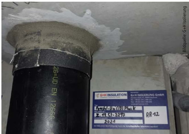
Abb. 4: Rohrabschottung PYROSTAT-UNI eingebaut
