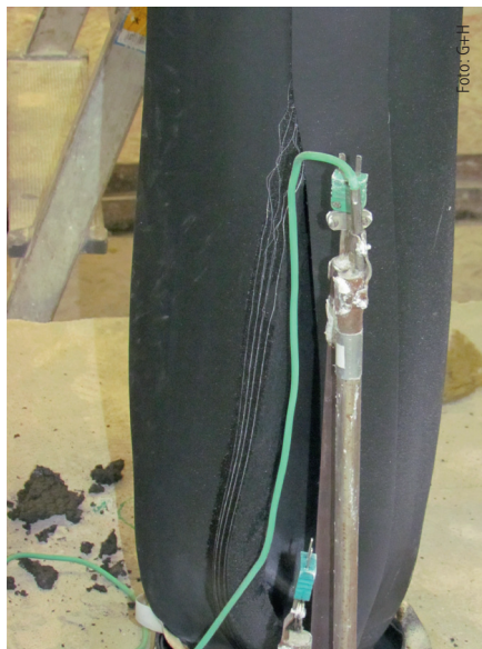
Abb. 3: Beginnendes Aufreißen der Verklebenahnt der Isolierung (Bild müsste gedreht werden)
