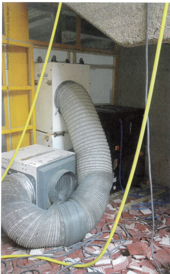
Speziallüfter sorgen für Unterdruck in den „Schwarzbereichen“.
