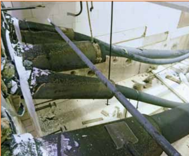
Abb. 3: Nach dem Brandversuch am 11. April 2012: Schlachtfeld auf der Feuerseite
