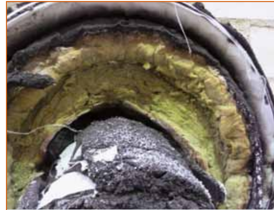
Abb. 5: Nach dem Brandversuch am 11. April 2012: Die Mineralwollestopfung weist keine Sinterungserscheinungen auf.
